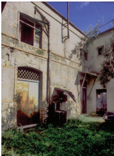
Fig. 6. Lo stato dell'edificio del Frantoio Nesci prima del restauro, esterni
