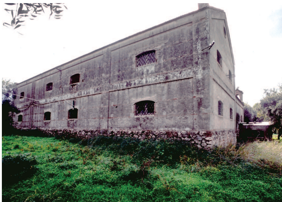
Fig. 4. Lo stato dell'edificio del Frantoio Nesci prima del restauro, esterni
