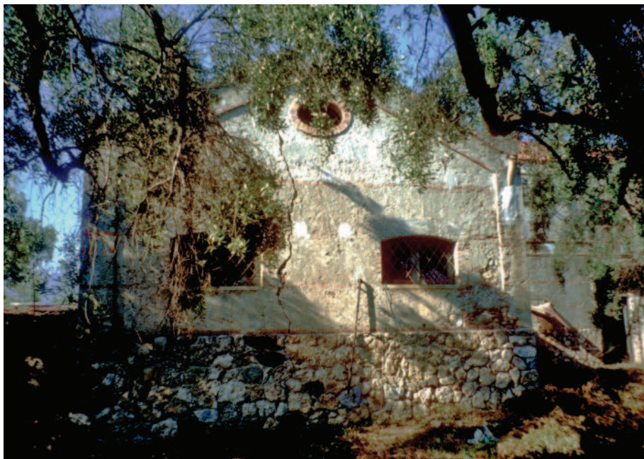
Fig. 5. Lo stato dell'edificio del Frantoio Nesci prima del restauro, esterni
