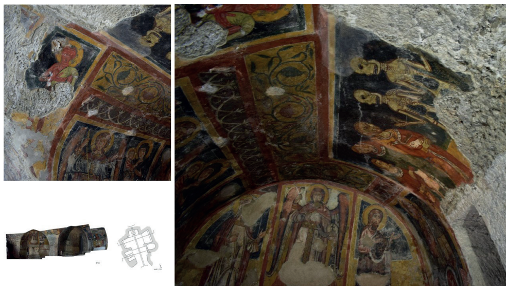
Fig. 2. S. Margherita Melfi, Cappella di S. Michele Arcangelo. Le principali forme di degrado rilevate sugli affreschi sono: antica lacuna (distacco lungo un piano di sedimentazione della roccia non attivo, consolidato da precedenti restauri), efflorescenze e macchie organiche (foto degli autori)
