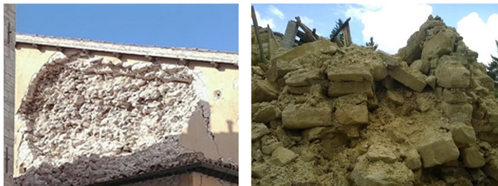
Fig. 2a-2b. Disgregazione delle murature di qualità scadente, costituite da ciottoli e da malte molto povere
