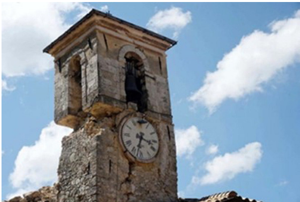
Fig. 7. Rottura della cella campanaria
