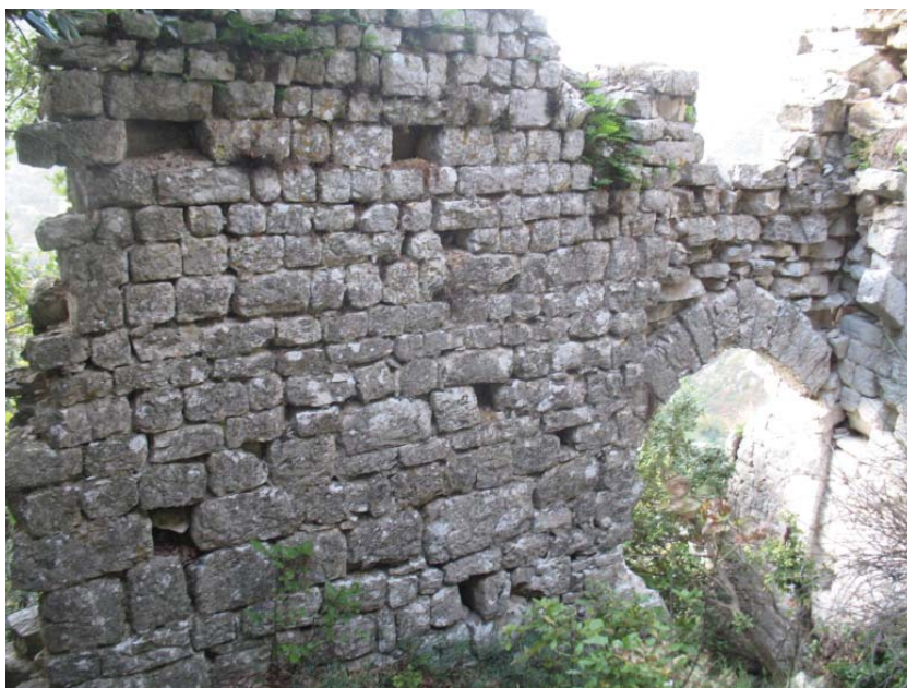
Fig. 12. San Benedetto de cripta Saxi Latronis , dettaglio del prospetto interno della cinta muraria CF 3 con vano di ingresso oggi completamente crollato
