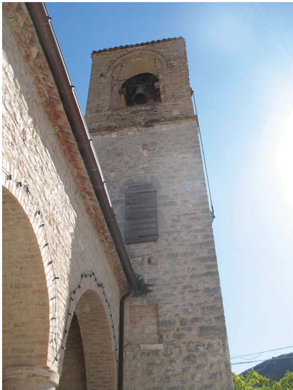
Fig. 2. Castel San Venanzio, torre campanaria della chiesa di San Lorenzo con ancora visibile l'originario accesso al piano superiore
